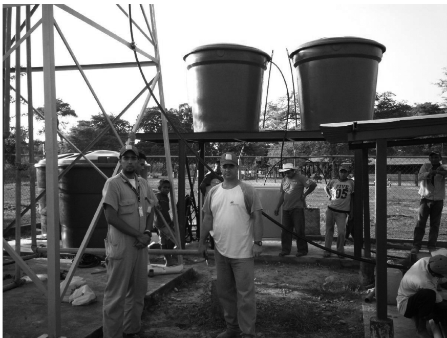
Instalación de depuradora de agua en Venezuela realizada por la cooperación cubana
